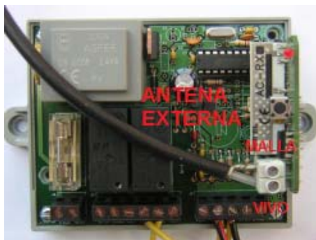
IMG-3. CONEXIONADO ANTENA EXTERIOR
